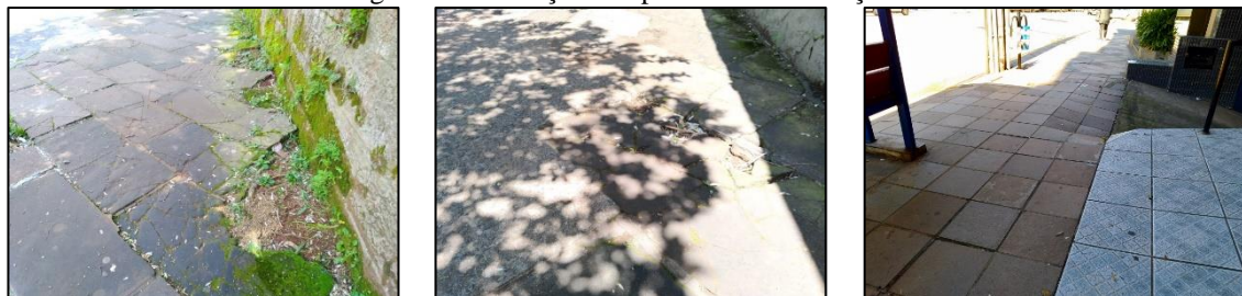
Figura 2 – Condições do pavimento das calçadas
