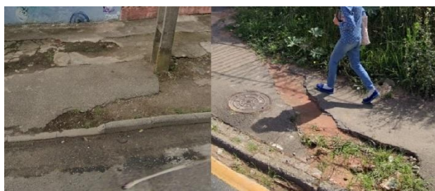
Figura 4. Vias desconformes e com fissuras
